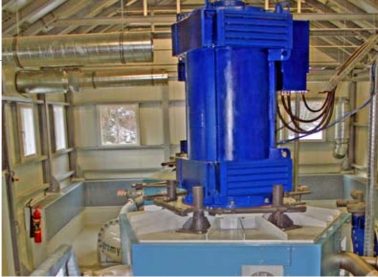
Blick in den Turbinenraum
